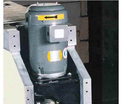
液压油泵总成安装在左后冲床床身脚座。
